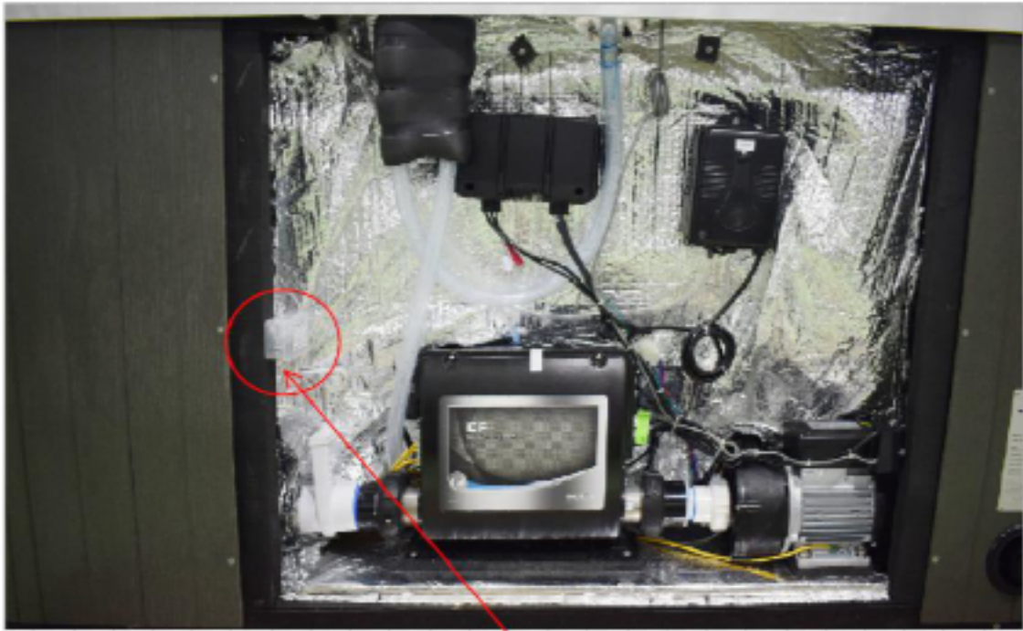
Расположение дополнительного предохранителя
